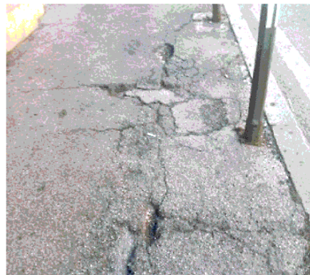
Una parte del marciapiede dissestato
